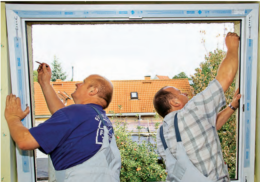
Die KfW vergibt Kredite und Zuschüsse auch für einzelne Modernisierungsarbeiten. Dazu gehört der Einbau neuer Fenster mit guten Dämmeigenschaften.
