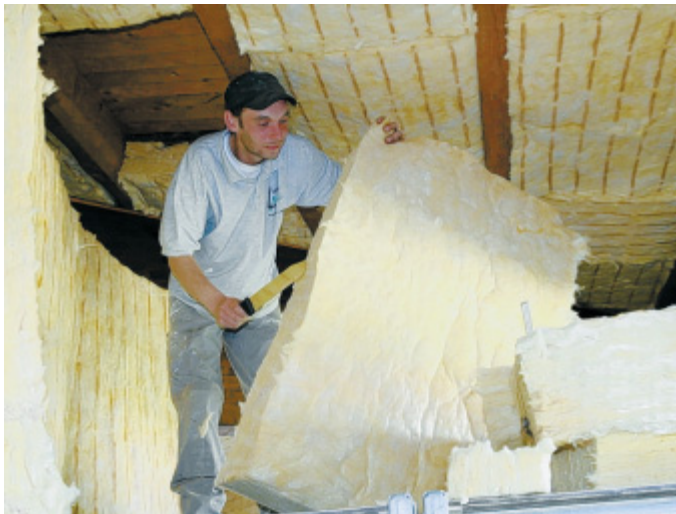
Mit dem Messer in der Hand: Gestern war Andreas Lütkepicht damit beschäftigt, neue, 18 Zentimeter starke Dämmplatten im Sparrenbereich der Saaldecke einzubauen.
